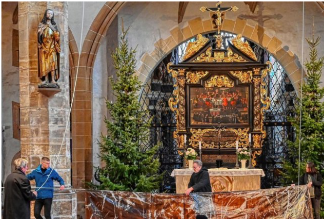
Mit einer speziell angefertigten Stahlseilkonstruktion wird das fünf mal zehn Meter große Bild vor dem Altar aufgezogen.
